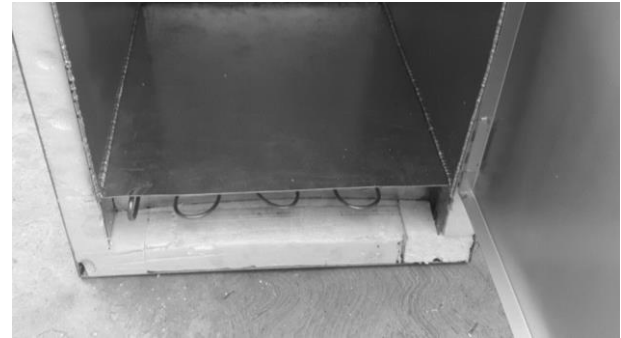
Figura 7 Detalle de la colocación del evaporador dentro de la cámara de enfriamiento Fuente: Elaboración Propia
